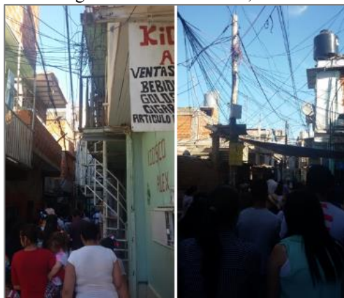
Imagen 8. Conexiones irregulares de red eléctrica, Ciudad Oculta, CABA, 2016
